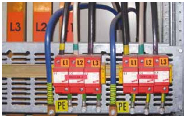
Fotografia 2. Odgromniki chroniące urządzenia przed przepięciami zainstalowane w głównej rozdzielni zasilającej.
