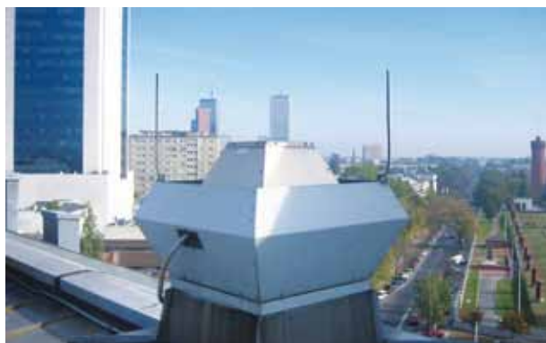
Fotografia 1. Instalacja odgromowa chroniąca obiekt użyteczności publicznej wykonana z wykorzystaniem metalowych elementów budynku.
