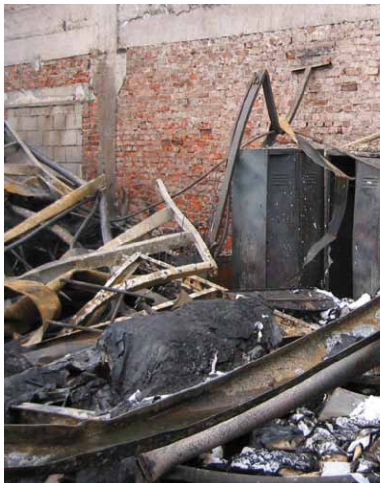
Zachowana ściana kompleksowa po pożarze
