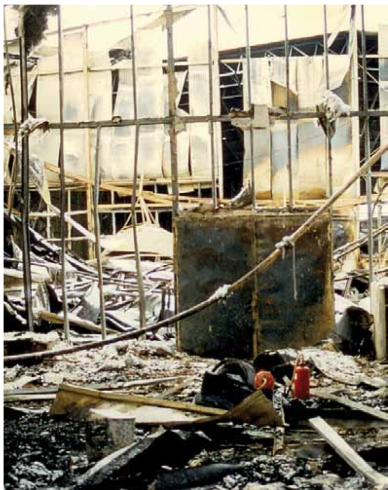
Zniszczona ściana przeciwpożarowa podczas pożaru
