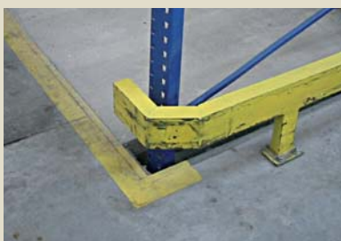
Fotografia 3. Zabezpieczenie regałów wysokiego składowania w odbojnice.
